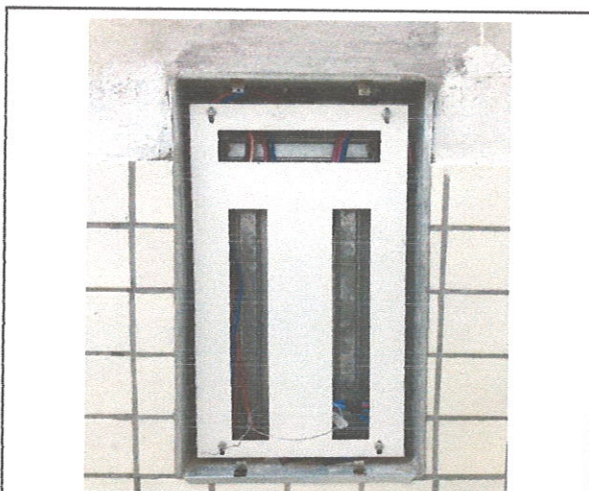
FOTO 111: Quadro de distribuição (Elétrica)
